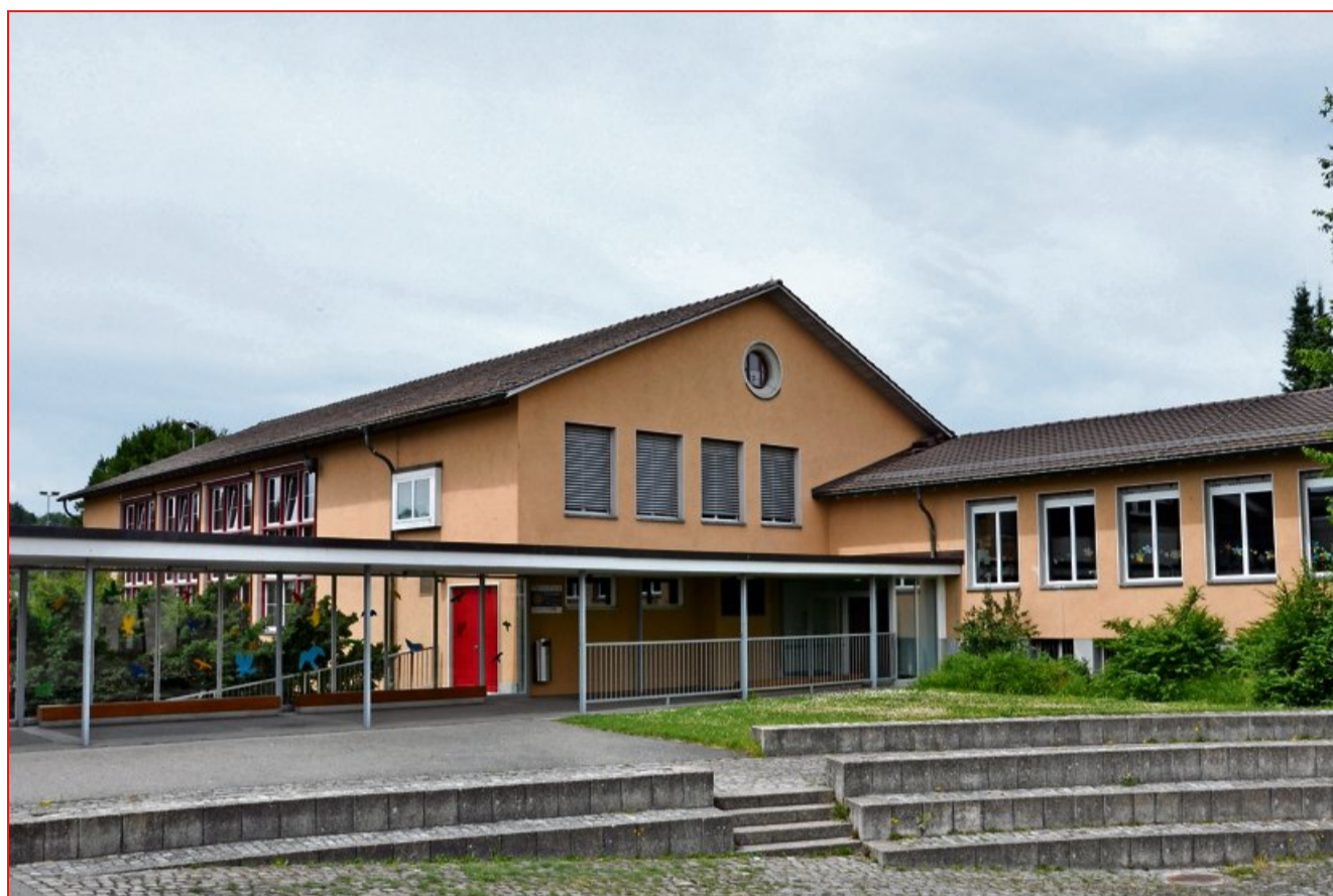
Heute müssen in der Turnhalle Worbiger bisweilen Kübel aufgestellt werden, um das Wasser, das durch das undichte Dach rinnt, zu fassen. Die Rümmlanger haben nun eine gute halbe Million Franken bewilligt für die Sanierung. Bild: zvg
